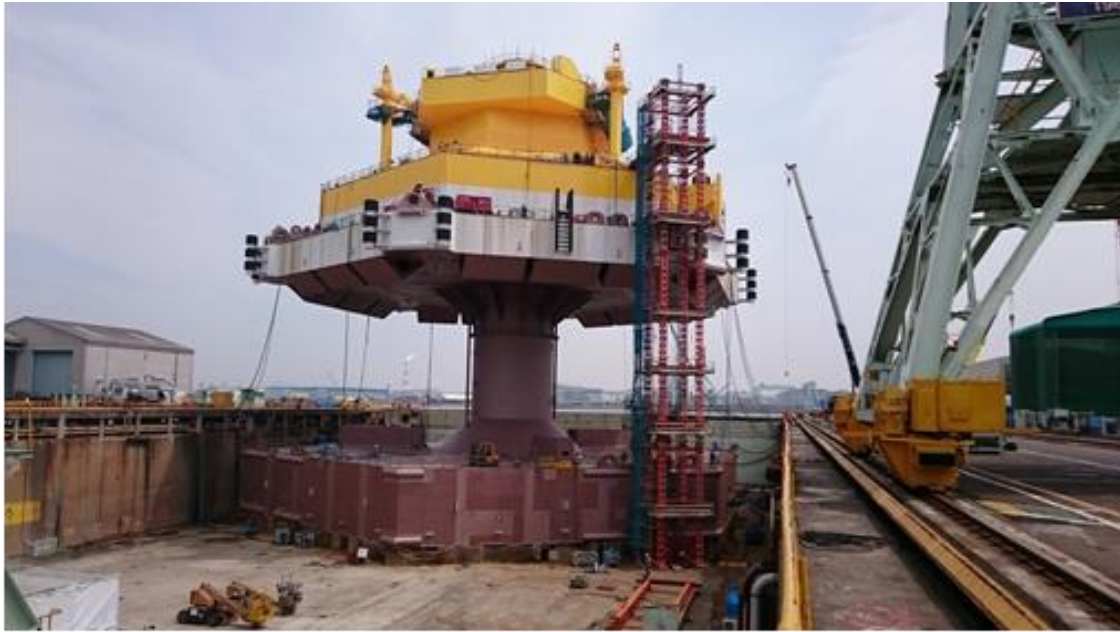
日立造船殿ドック内
