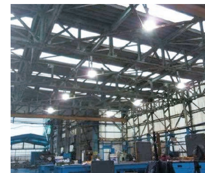
照明のLED化推進(磯子)
