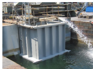
図9 チャンバー内部からの排水 Fig.9 Drainage from inside the chamber
